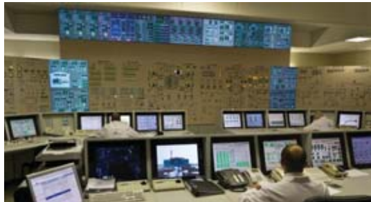
Elektron idarəetmə mərkəzi
