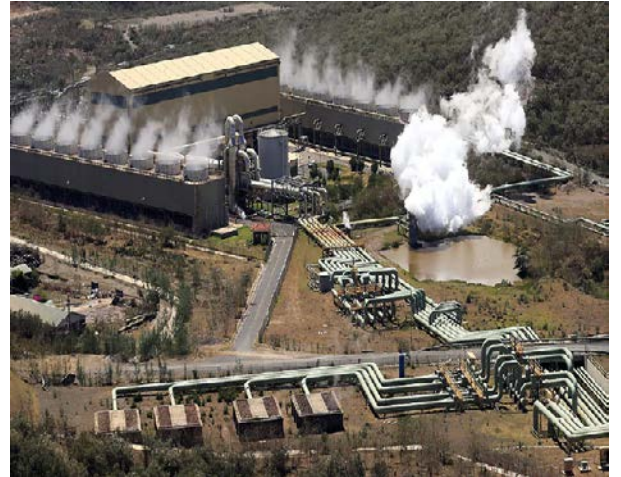
Ş.3.16. Keniyanın Nakuru bölgəsində 140 MVt gücündə "Olkaria-4" Geotermal Elektrik Stansiyası.
